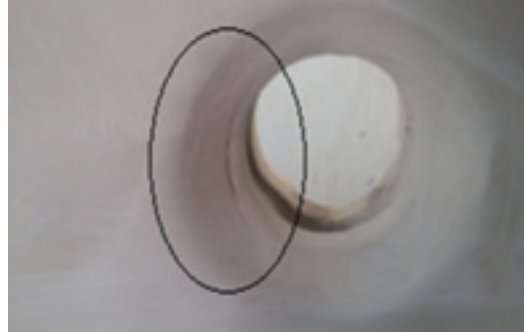
شكل (1) يوضح إحدى شروخات الصب
